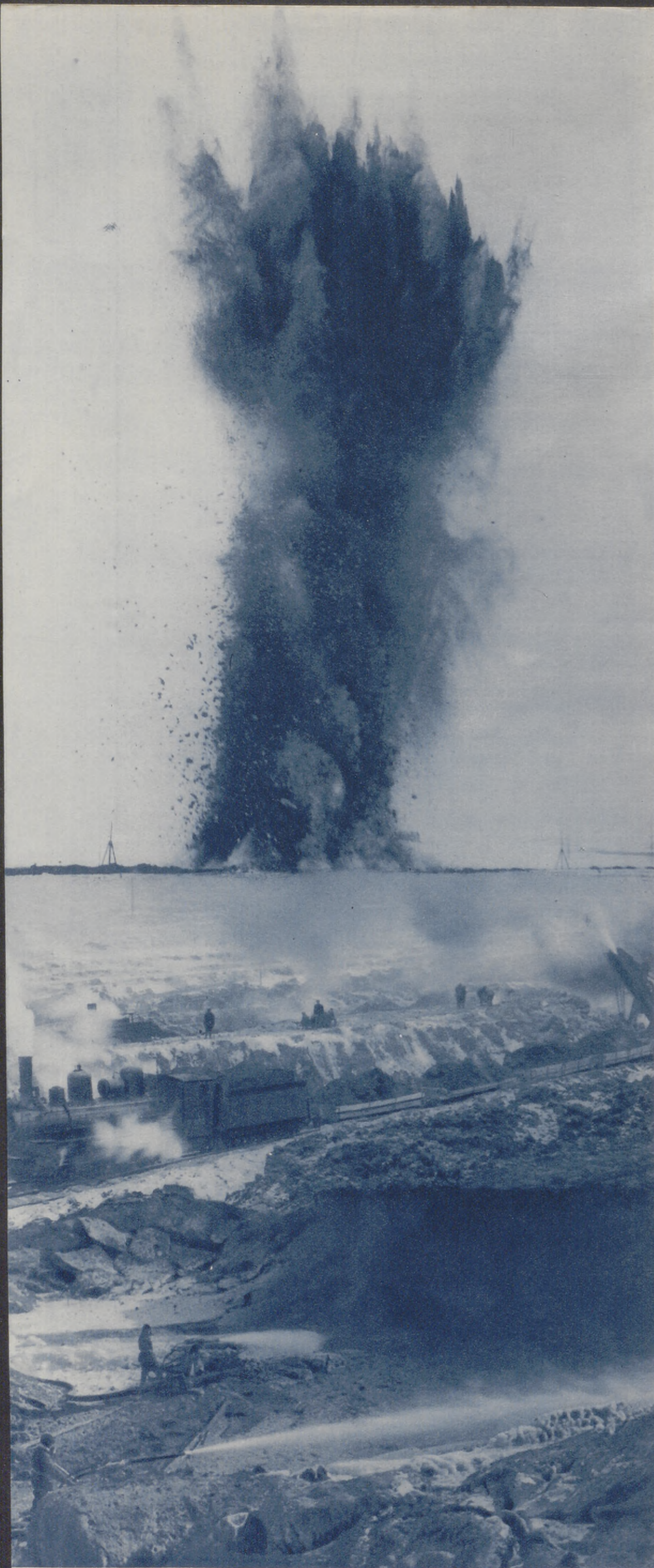
AL COMIENZO SE HIZO SALTAR LA TIERRA; LUEGO SE HUNDIERON EN ELLA LAS EXCAVADORAS. Y ASÍ COMENZÓ LA CONSTRUCCIÓN....
